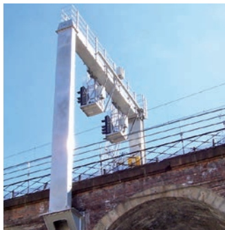
Portique porte feux SNCF sur ouvrage d'art
